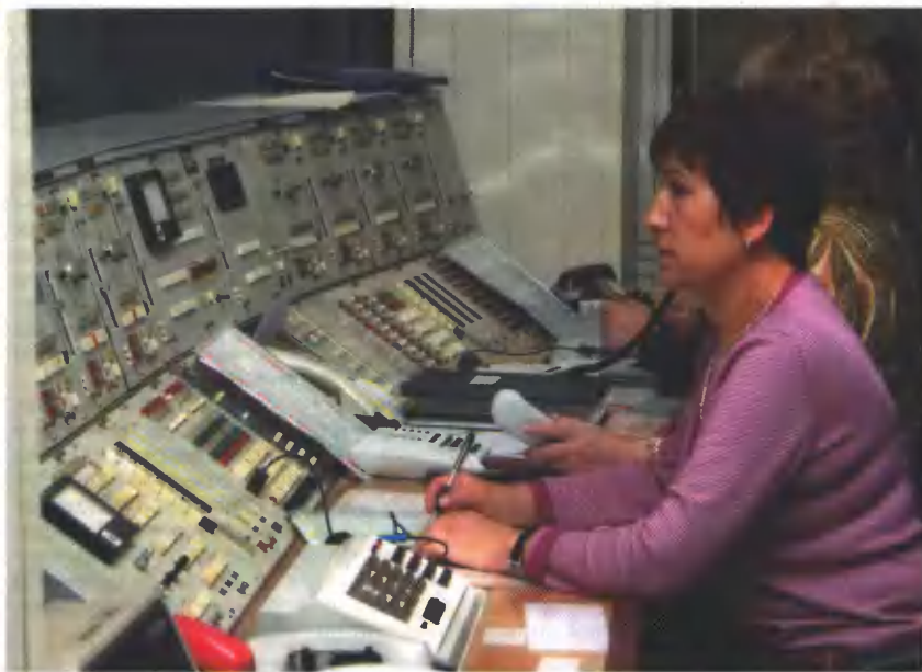
Центральная аппаратная московской станции проводного вещания.
